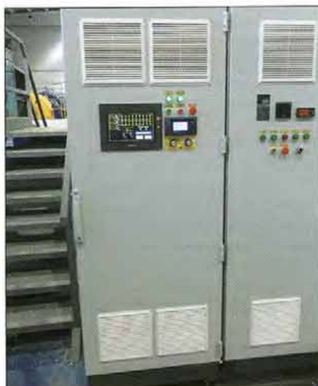
Рис. 18. Внешний вид НПЧ и шкафа водяного охлаждения
